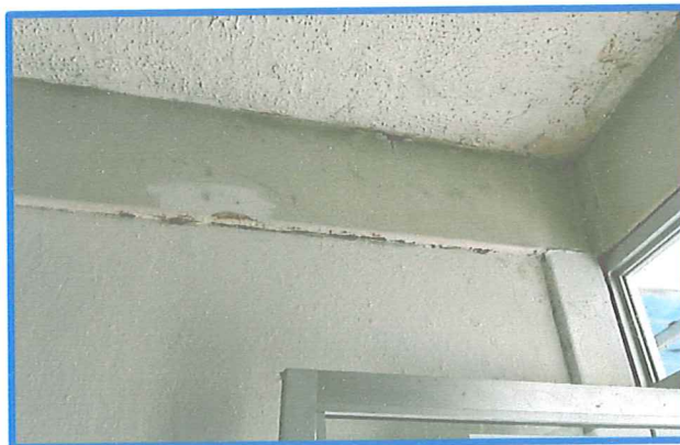
Grieta por junta constructiva en el edificio G.
