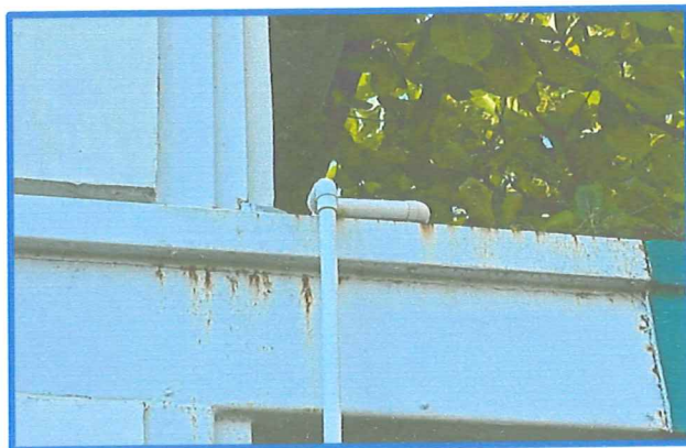
Oxidación de perfiles en el edificio B.
