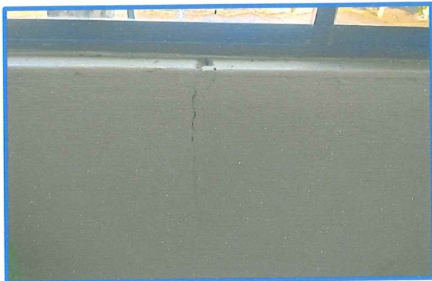
Grieta en el edificio B.
