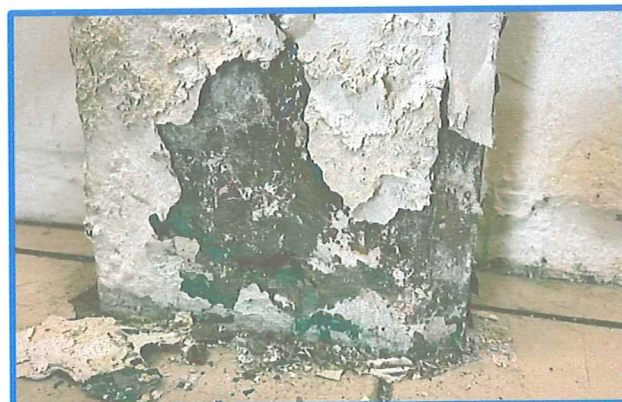
Humedad y desprendimiento de pintura en columna del edificio E.
