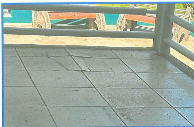
Loseta quebrada en el edificio F.
