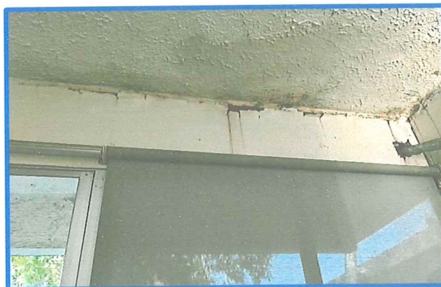
Corrosión de perfil en el edificio G.
