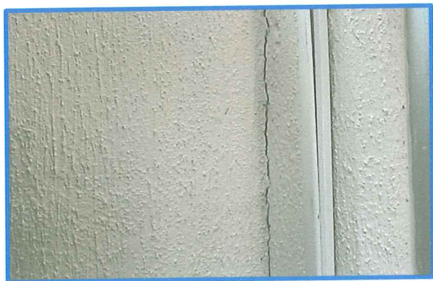
Grieta en el edificio F.
