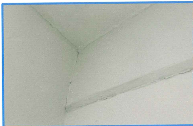
Grieta por junta constructiva en el edificio E.
