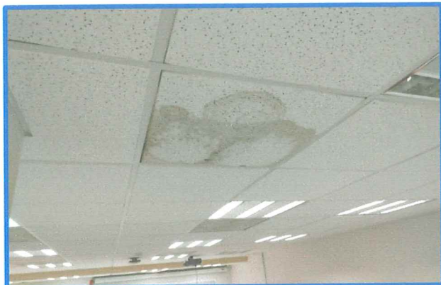
Humedad y filtración en plafón del edificio B.
