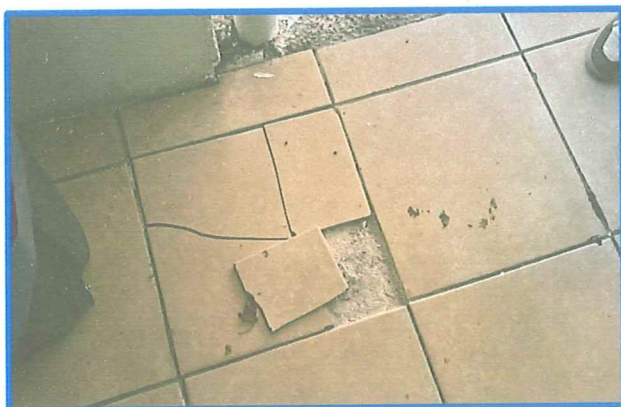
Loseta quebrada en el edificio B
