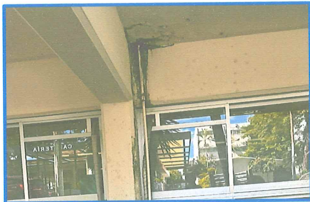
Humedad y filtración en el edificio F.
