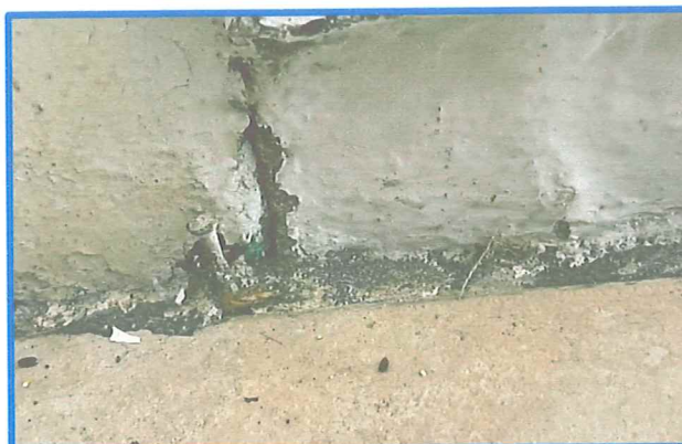
Exposición del acero de refuerzo en el edificio B.
