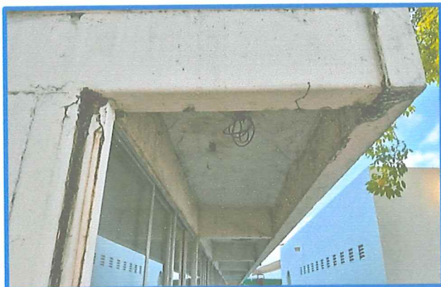
Humedad y filtración en columna del edificio G.
