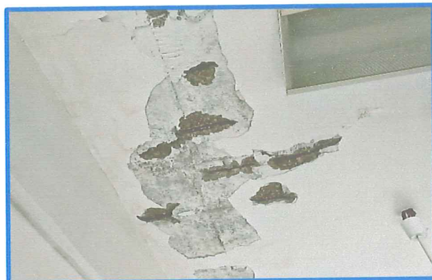
Exposición del acero de refuerzo en el edificio C.
