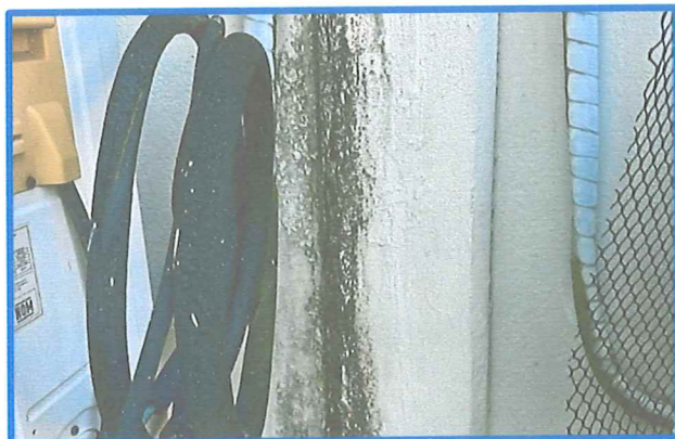
Humedad y filtración en el edificio A.
