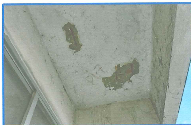
Exposición del acero de refuerzo en el edificio G.
