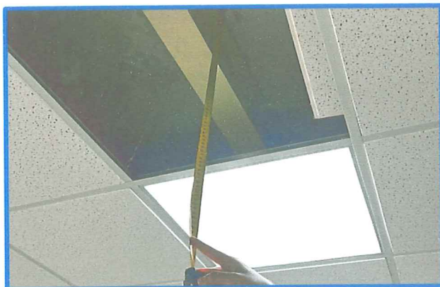
Refuerzo en losa del edificio E (area de recepción planta baja) mediante perfil IR, debido a una deflexión.
