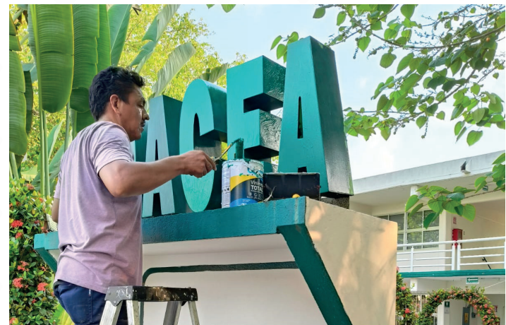
Mantenimiento de las instalaciones de la DACEA.
