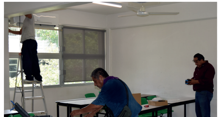
Instalación de nodos de red en el Edificio D.
