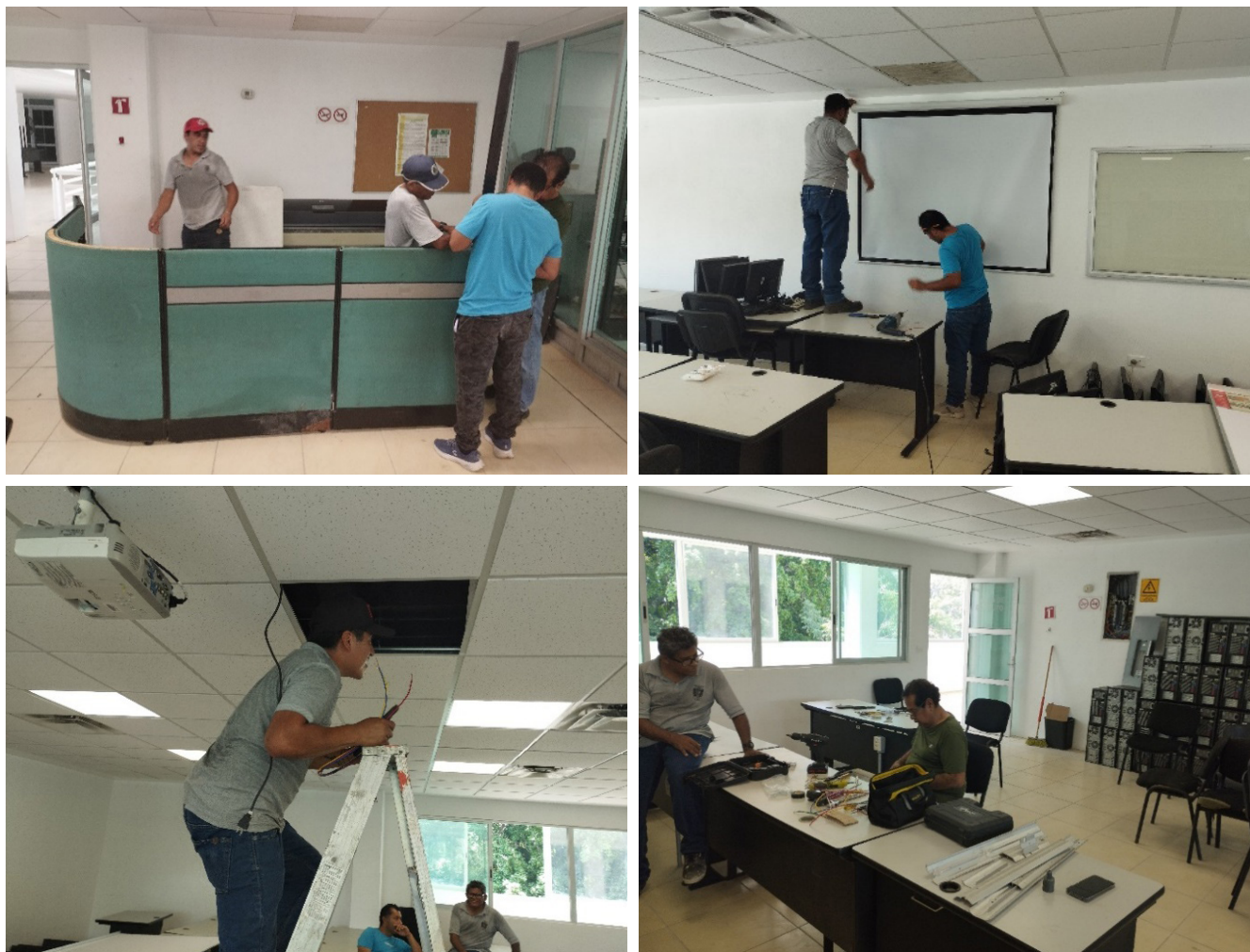
Figura 11. Acciones de mantenimiento en instalaciones de cómputo.
