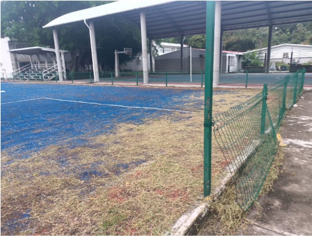
Figura 8. Estado de las instalaciones deportivas antes de la intervención de mantenimiento.
