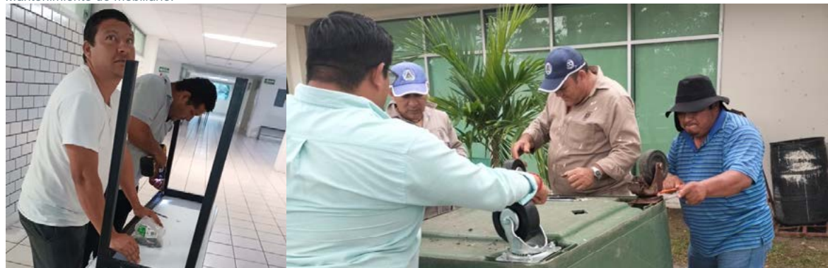
Imagen 5.6 Mantenimiento de mobiliario.
