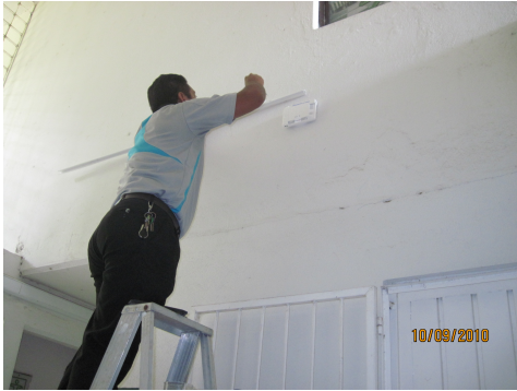
Figura 21. Instalación de puntos de acceso inalámbricos
