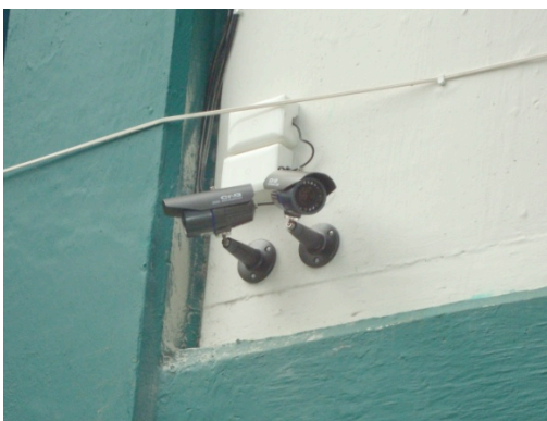
Figura 33. Cámaras de circuito cerrado
